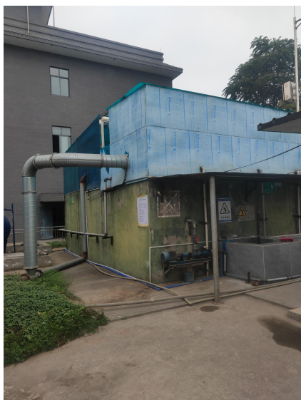
厂区污水处理站
