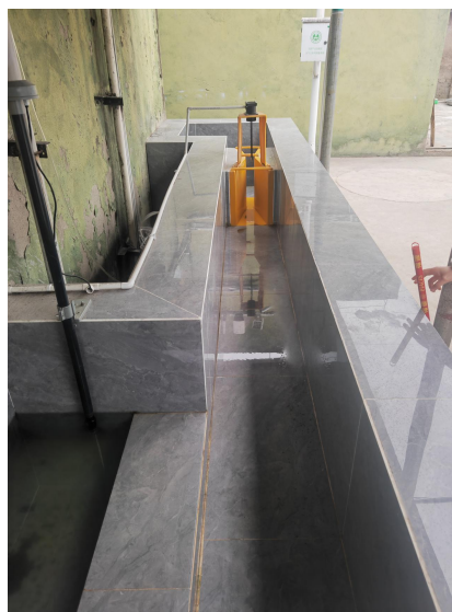
厂区废水总排口（DW002）
