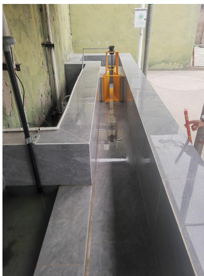
厂区废水总排口
