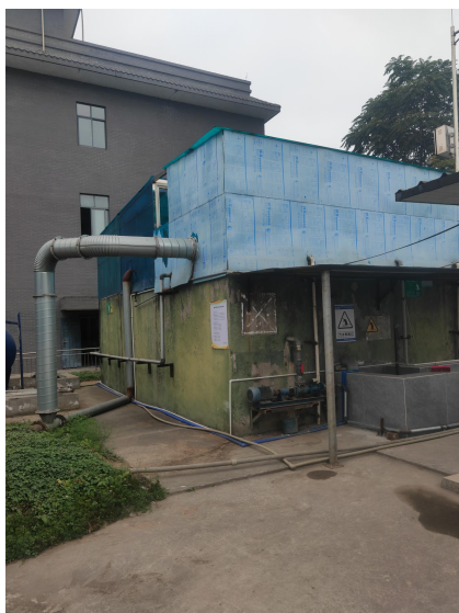
厂区污水处理站
