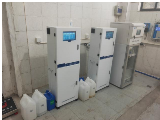
厂区废水在线监测室
