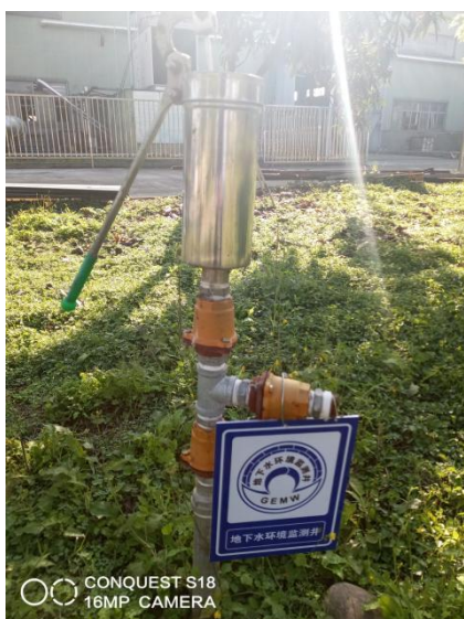
厂区地下水监测井 1（已建）
