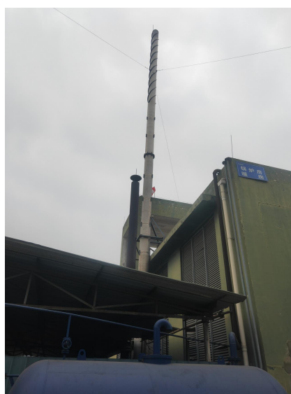
焚烧炉废气排放口、导热炉废气排放口
