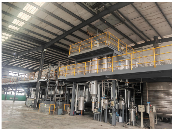
密闭生产管道、设施
