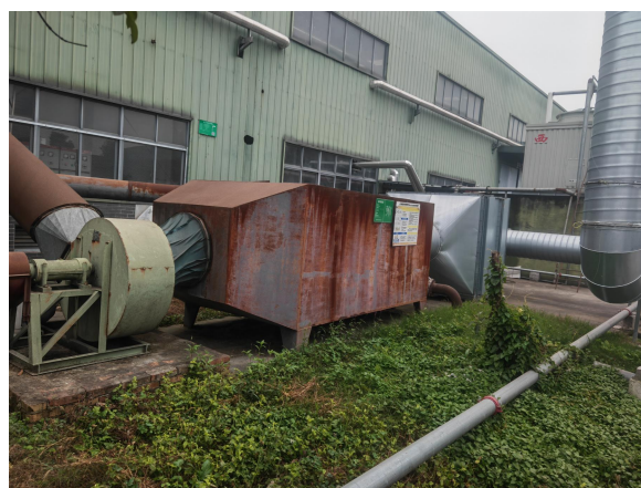
研发中心废气处理设施（二级活性炭）
