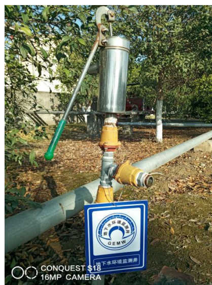
厂区地下水监测井 2（已建）
