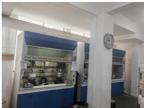
实验室废气收集设施
